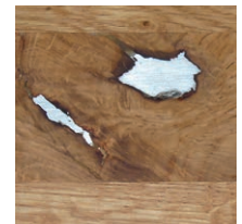
Mit Zinn ausgegossene Astlöcher und Risse.
